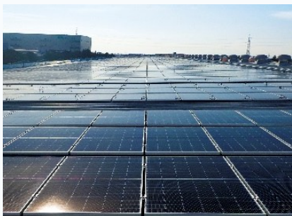
自家消費型太陽光発電設備
