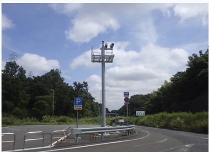
監視カメラシステム
