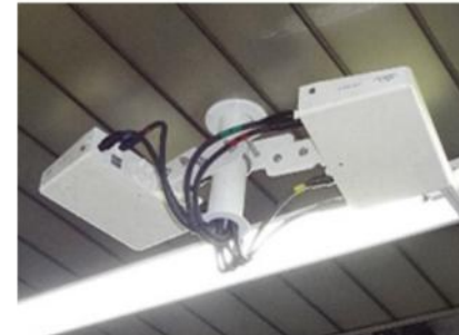
屋内設備（不感地帯対策）
