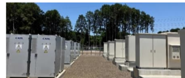
佐賀県 武雄蓄電所建設工事 定格出力2MW、定格容量8MWh
