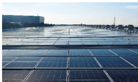
自家消費型太陽光発電所
