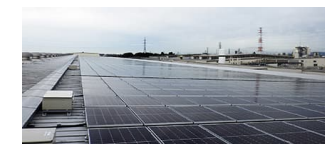
自家消費型太陽光発電所
