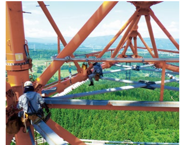
高圧架空送電線設備 保守業務委託工事
