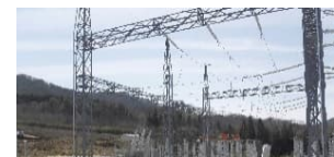
太陽光発電所内 特別高圧変圧設備
