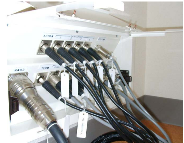
壁面AV設備接続盤 ー接続部
