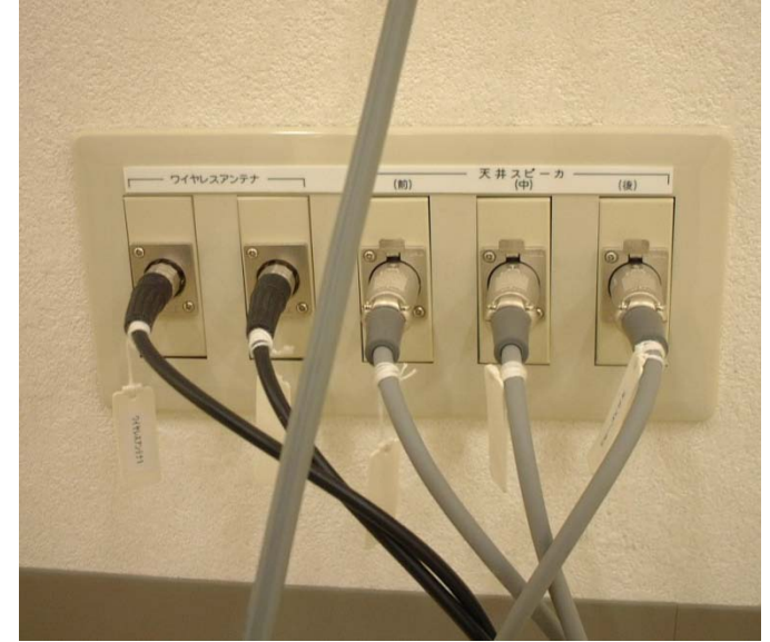
壁面AV設備接続プレート
