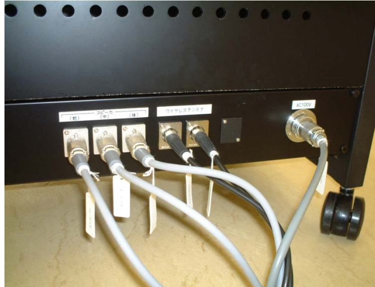
ラック用AV設備接続パネル
