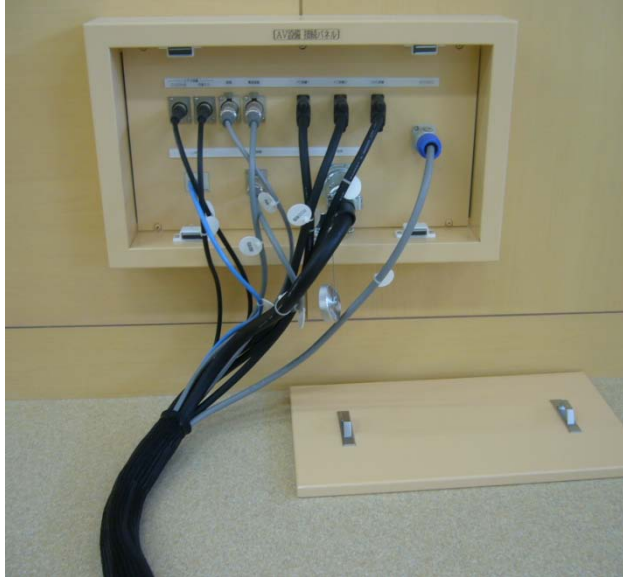
壁面AV設備接続盤
