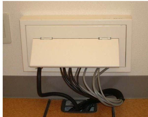
壁面AV設備接続盤 ー外観
