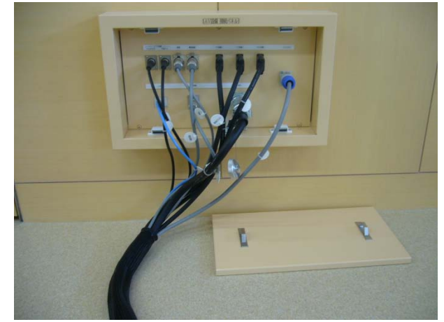
壁面と同じ色合いの接続盤
